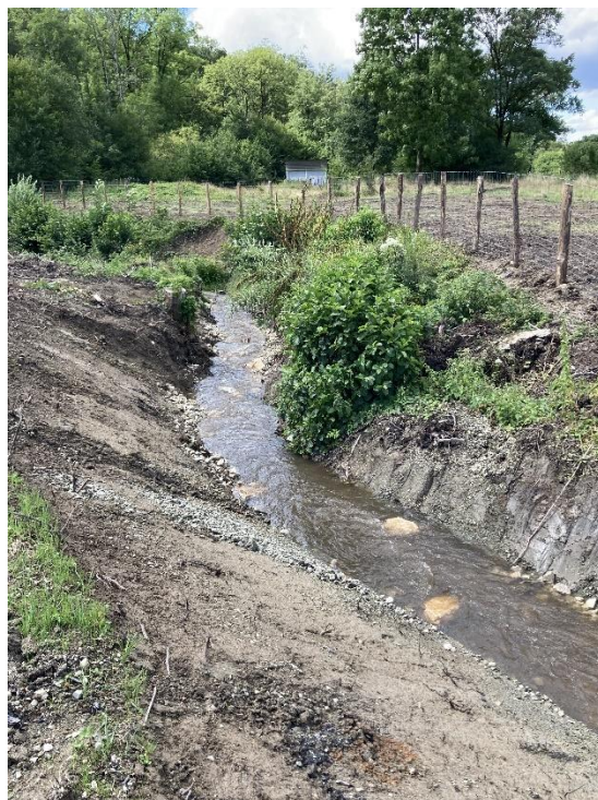
Tronçon aval à la RD 2 après un fort épisode orageux début août 2023.
