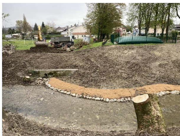
Vue sur une banquette de rive droite aménagée avec en arrière-plan la réserve incendie de type citerne souple installée.
