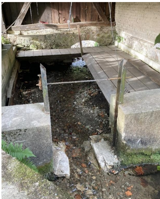
Concernant le vannage du lavoir, le vannage a été démantelé et une échancrure réalisée dans le petit seuil sous-jacent au vannage.
