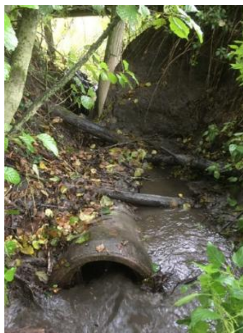
Busage déstabilisé vu de l'amont.
