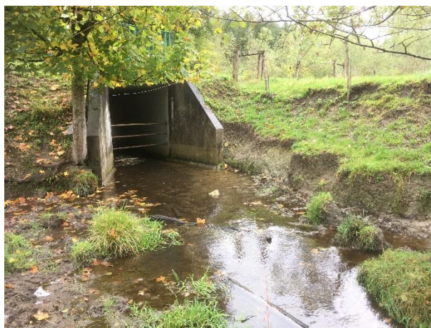
La passerelle pour bétail étant déstabilisée, les bovins passaient à gué sur le ruisseau, dégradant le ruisseau par leurs déjections et leur piétinement. Juste en aval du pont de la RD 67, le passage à gué des bovins. Le lit y est fort piétiné et surélargi. Ce surélargissement impacte la continuité écologique en étiage (photo prise en période de module et après la saison de pâturage fin octobre).
