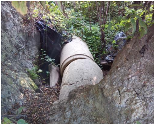
Autre point de vue sur ce busage complètement déstabilisé en étiage. Des morceaux de bâche agricole se retrouvent également dans le lit mineur.
