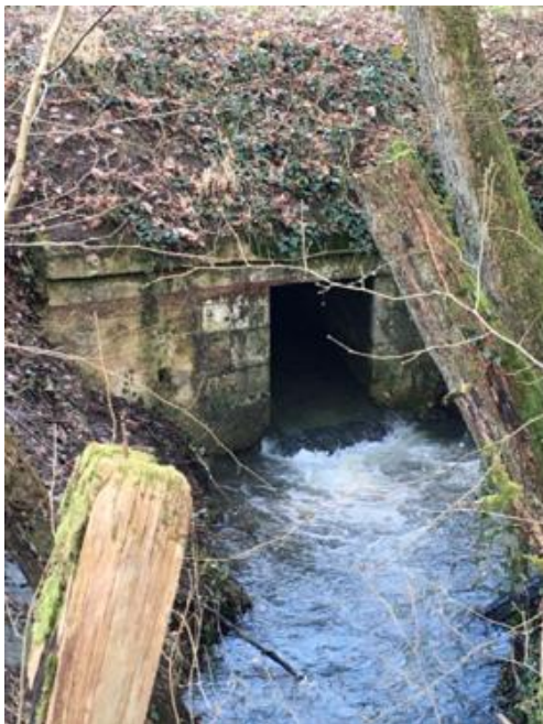
En hautes eaux l'ouvrage demeure difficilement franchissable.
