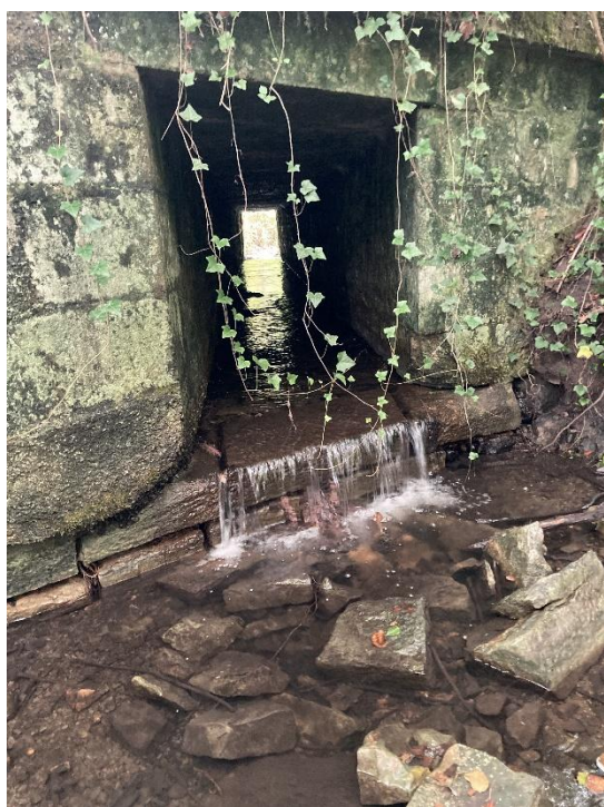
Ouvrage RD 2 faisant obstacle à la continuité écologique du ruisseau des Courtes Chausses (chute d'eau de 30 cm en étiage + tirant d'eau insuffisant au sein de l'ouvrage).
