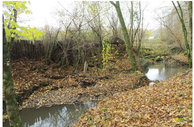
Vue sur deux protections de berge. En arrière-plan à droite, la protection de berge en enrochements qui a glissé dans le cours d'eau. En arrière-plan à gauche, une protection de berges en pieux jointifs. On observe également au milieu de la photo la présence de 2 pieux issus d'une protection de berge qui ont dû être arrachés par le ruisseau et qui se retrouvent dans le lit du cours d'eau au milieu d'un embâcle.
