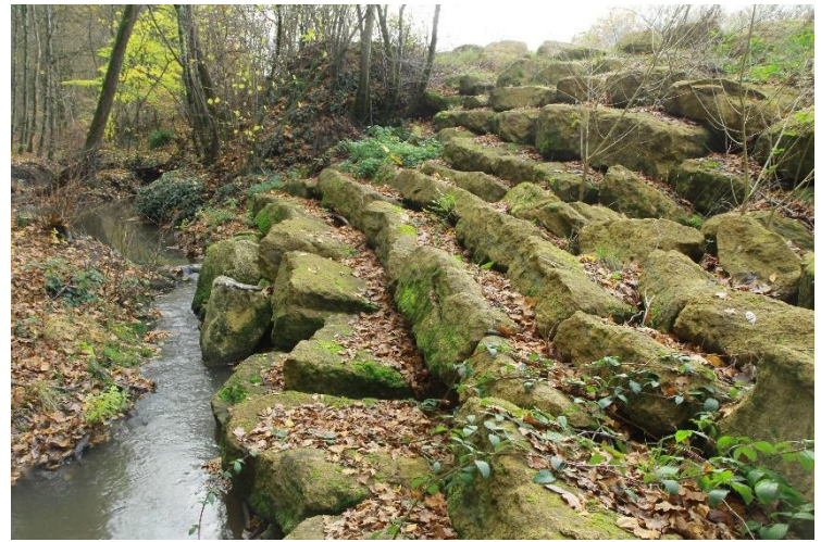
Le glissement des enrochements a resserré considérablement le lit mineur en créant un goulet d'étranglement : passage très étroit du ruisseau inférieur à 50 cm en étiage. En hautes eaux, ces enrochements génèrent de grosses turbulences, menaçant davantage les accotements du chemin.
