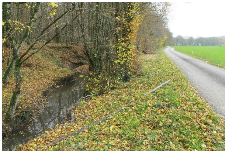
Le fort encaissement du lit déplacé, sa proximité avec le chemin, le caractère argileux du sol et sous-sol, la pente relativement marquée du cours d'eau et les fortes amplitudes de débits, concourent à une forte dynamique du ruisseau et à la déstabilisation du chemin.
