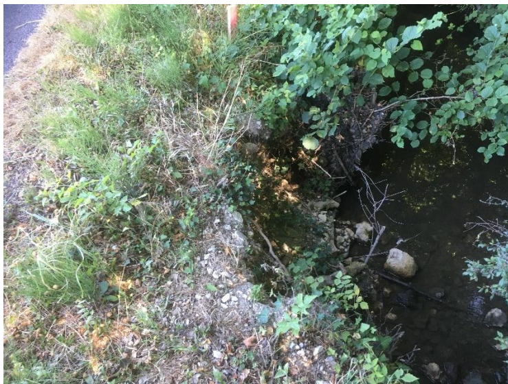
Encoche d'érosion située à moins d'1m de la chaussée.
