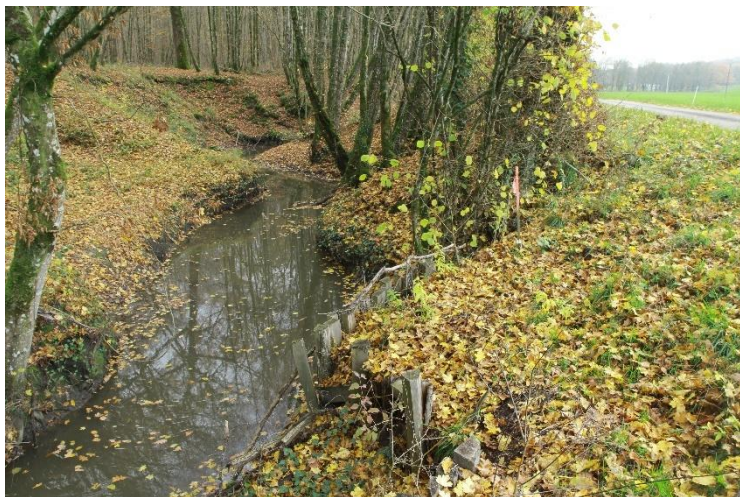
Vue sur le lit actuel encaissé du ruisseau de Beauchamp longeant le chemin. Au premier plan, une protection de berge en pieux jointifs. Quelques pieux ont légèrement glissé.
