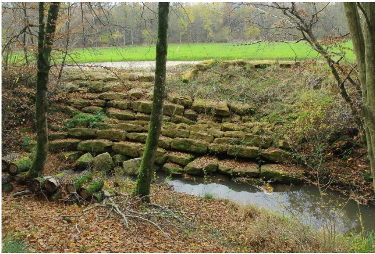
Vue depuis la berge droite de la protection de berge en enrochements qui a glissé dans le cours d'eau.
