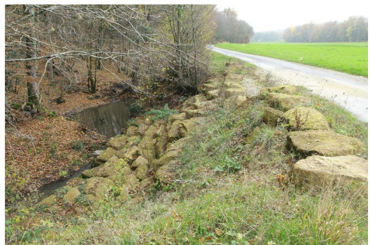
En raison du caractère argileux des berges, du fort encaissement du cours d'eau et du poids des enrochements, la protection de berge en enrochements a glissé et une partie de la chaussée emmenée.
