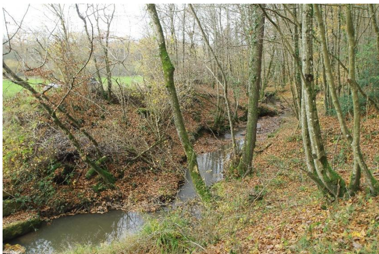
Autre point de vue sur le lit actuel fortement encaissé du Beauchamp, sa proximité avec le chemin et les multiples encoches d'érosion menaçant le chemin.
