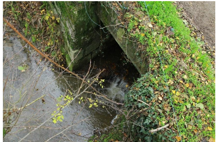
Pont amont d'accès à la ferme de Beauchamp. L'incision du lit du Beauchamp en aval génère une rupture de la continuité écologique au droit du pont : dénivelé amont-aval du pont= 1,20 m ! Cette chute d'eau infranchissable vient également menacer la stabilité du pont ; pont qui en outre est relativement ancien et sollicité par le passage des engins agricoles actuels. Le projet de remise en fond de vallée du ruisseau permettra de rétablir la continuité écologique au droit du pont (obligation réglementaire au titre de l'article L.214-17 du code de l'environnement sur ce cours d'eau classé en Liste 2), mais également d'assurer la stabilité de ce pont vétuste pour les engins agricoles l'empruntant puisque le ruisseau ne circulera plus sous le pont et qu'il sera remblayé.
