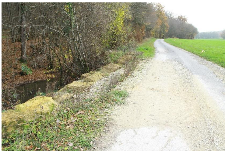
Partie de la chaussée qui a été érodée par le Beauchamp, puis restaurée en 2018 avec une protection de berge en enrochements, puis à nouveau déstabilisée suite au glissement des enrochements.
