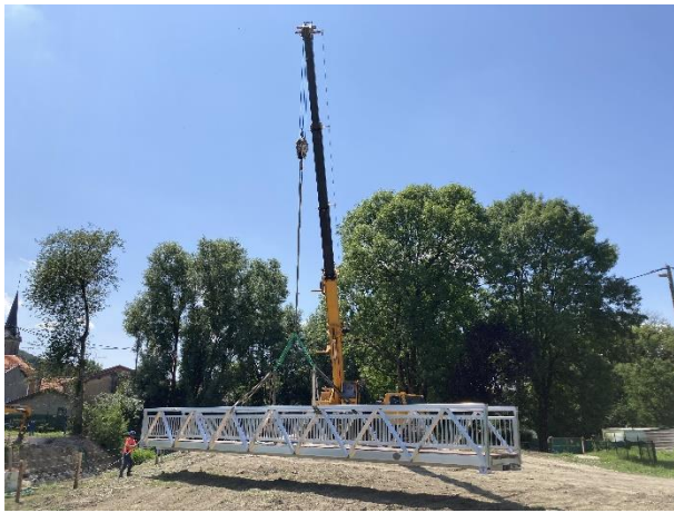
Juillet 2023 : Pose de la passerelle piétonne permettant d'assurer le franchissement du lit mineur au droit du chemin communal fortement emprunté.
