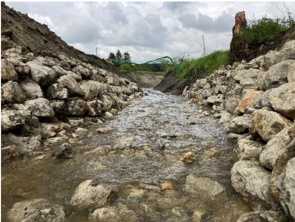
Stabilisation des berges au droit de l'ouvrage démantelé et stabilisation également du fond du lit avec la création d'un radier composés d'engrèvements, de blocs et de concassés 80-200 cm. Vue depuis l'aval.
