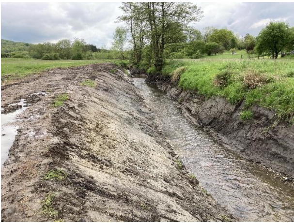
Partie amont de la berge droite retalutée et du lit reprofilé pour une pente de 0,8 %.
