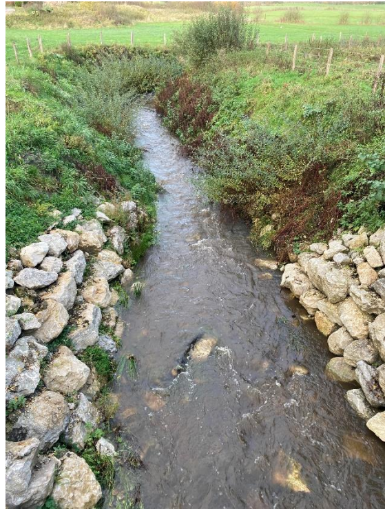
Ruisseau de Beauchamp en amont de la passerelle en novembre 2023. Les berges se sont bien revégétalisées et les boutures de pied de berges ont très bien repris, les boutures sont bien denses avec des rejets déjà supérieurs à 1 m.
