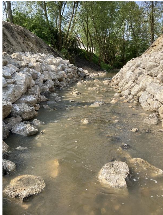
Vue depuis l'amont sur le radier façonné et les berges stabilisées au droit de l'ouvrage dérasée.
