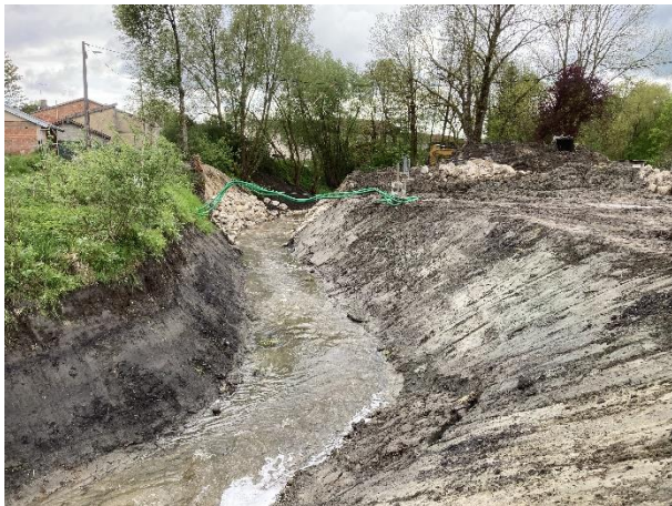
Nécessité de reprofiler le lit mineur en amont de l'ouvrage sur une centaine de mètres : pente du lit reprofilé = 0,8 % ; berge retalutées en rive droite essentiellement car berge droite verticale et située dans une ample concavité du méandre (recul du haut de berge de 1 m en rive droite).
