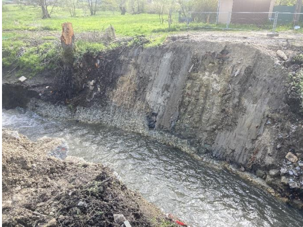
Fort encaissement du lit mineur après dérasement de l'ouvrage et réactivation de l'érosion régressive.
