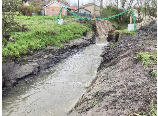
Vue depuis l'amont sur le lit du cours d'eau suite au dérasement de l'ouvrage. L'érosion régressive progresse rapidement sur un fond composé de vases compactes et argiles.
