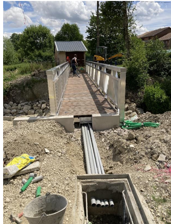
Après pose de la passerelle, des fourreaux sont mis en place sous la passerelle afin d'accueillir les réseaux de télécommunications définitifs. Ces derniers après réception des travaux seront remis en place courant septembre 2023 par Orange et Losange.
